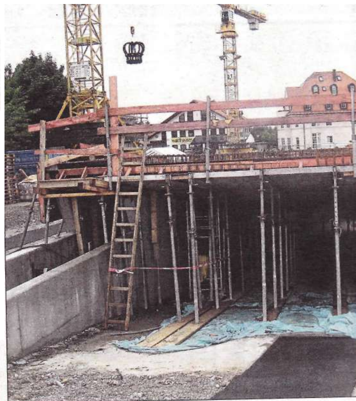
Die Parkgarage am Hirtenweg nimmt Formen an. Im Dezember sollen sie fertig sein.
